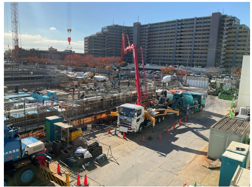
工場棟雨水貯留槽地下1階立上躯体工事 コンクリート打設状況(北側)
